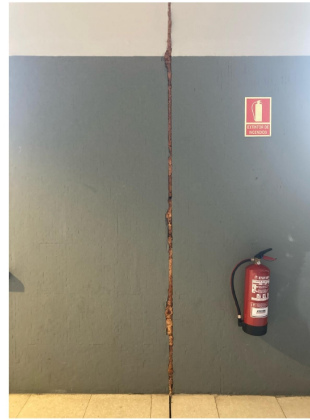
Grieta vertical reparada provisionalmente con espuma en la segunda planta
