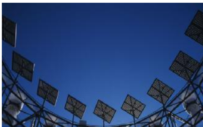
Figura 4.10. Detalle de la instalación solar fotovoltaica.
