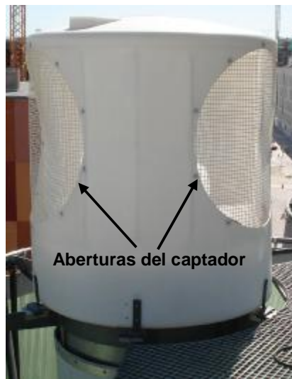
Figura 4.7. Captador de vientos de cada torre.
