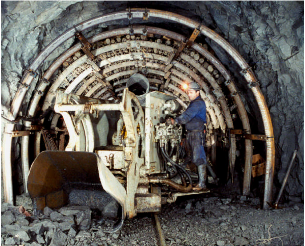
Cargadora neumática en frente de corte de guía. Observar la sujeción por entibación. - Foto 5 -
