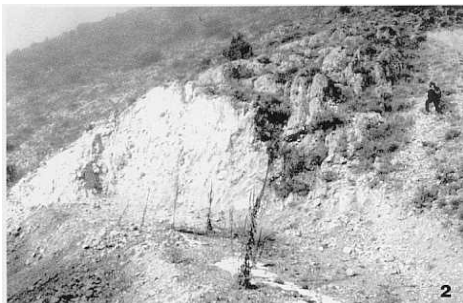
Lámina 5. Fig. 1: Sección de la rambla del Salto. Aspecto general de los materiales del Jurásico Inferior y Medio en este punto (formaciones Barahona, Turmiel y parte inferior de la Fm. Chelva). Fig. 2: Rambla del Salto. Vista parcial de los desmontes y afecciones (pequeñas canteras) realizados sobre los materiales de la Fm. Chelva.
