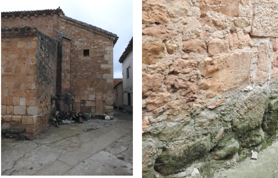
Fig. 8: Humedad y erosión en los sillares exteriores de la iglesia.
