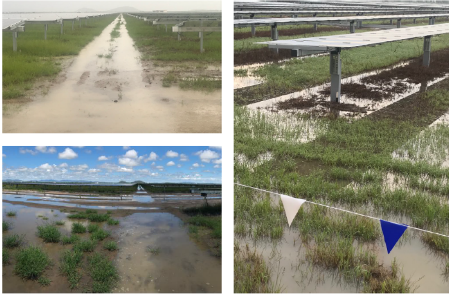
Figura 12 Aspecto del parque solar tras las inundaciones, fotografías cortesía de GEOINTEC
