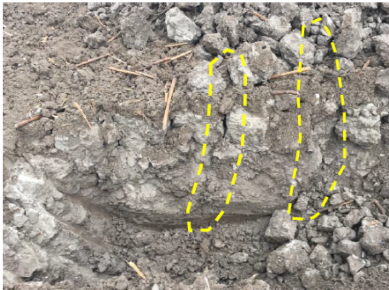
Figura 5 Grietas de retracción vistas con ayuda de una calicata
