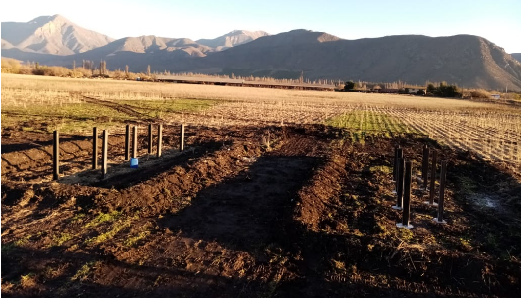
Figura 17 Aspecto de los dos grupos de perfiles de una de las ubicaciones, a la izquierda perfiles hincados de manera directa y a la derecha perfiles con predrilling y relleno granular, fotografía cortesía de GEOINTEC
