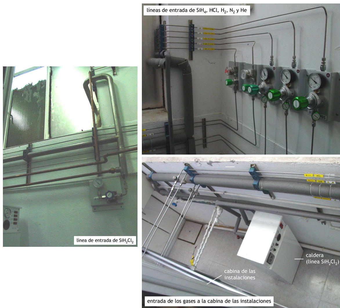
Figura 2.21. Imágenes de las líneas de suministro de \text{SiH}_2\text{Cl}_2 , \text{SiH}_4 , \text{HCl} , \text{H}_2 , \text{N}_2 y \text{He} que conectan la caseta exterior y la cabina donde se ubican los equipos.
