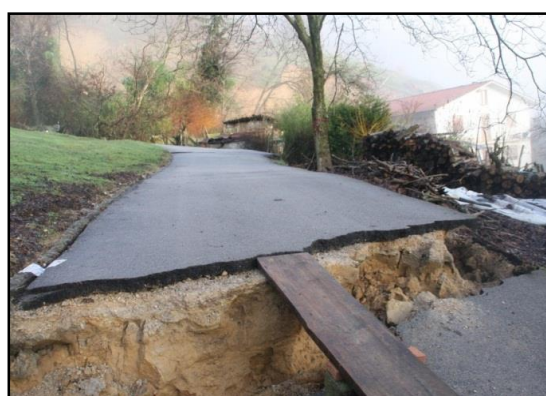
Figura 22. Rupturas en la carretera
