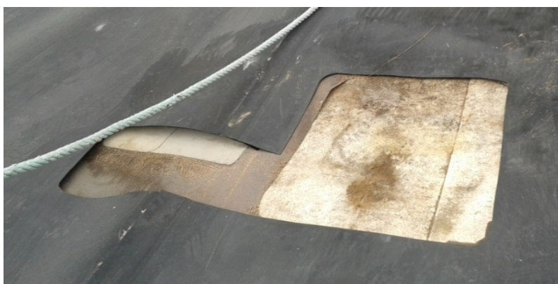
Figura 8.2. Aspecto del geotextil que se encontraba debajo de la geomembrana de PVC-P, una vez extraída la muestra (fotografía de Balten)
