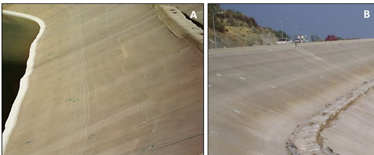
Figura 6.27. A: fallos detectados en la lámina impermeabilizante de PVC-P a los 48 meses. B: parches colocados en grietas para evitar fugas
