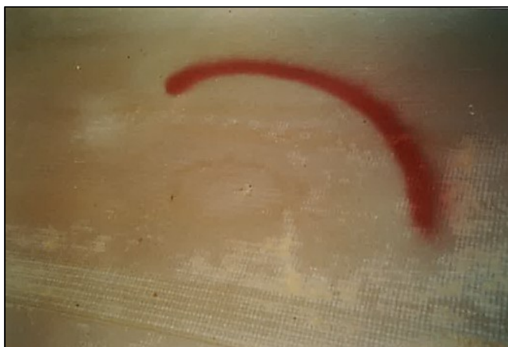
Figura 6.26. Detalle de una de las grietas detectada a los 24 meses. Se observa también el cambio de coloración y la pérdida de resina de la geomembrana, quedando el refuerzo de hilos de poliéster al aire
