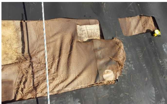
Figura 8.1. Aspecto de la geomembrana de PVC-P bajo la geomembrana de PEAD en la zona de coronación del talud norte a 216 meses (fotografía de Balten)
