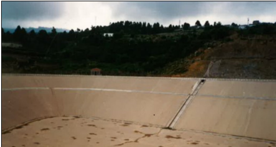
Figura 6.24. Estado de la geomembrana de PVC-P a los 12 meses desde su instalación
