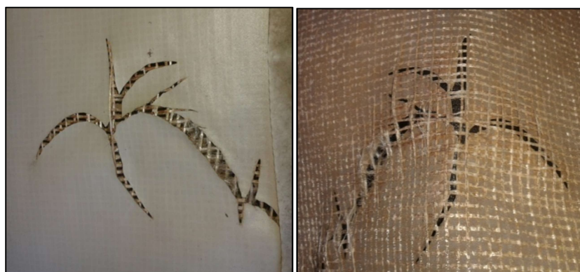
Figura 8.6. Detalle de agrietamiento en la muestra de geomembrana de PVC-P procedente de la zona intermitente (figura 8.4)
