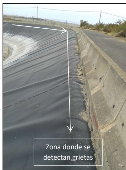
Figura 7.49. Zona de coronación del embalse de Buen Paso, donde la geomembrana cambia de dirección y se detectan grietas
