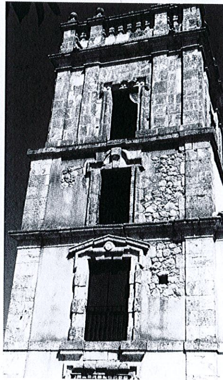
Fig. 1.- Pérdida del revoco y enfoscado, con aparición del muro de mampostería calcáreo. Loss of whitewashing with appearance of wall of calcium masonry. Iglesia -Palacio de Goyeneche, Nuevo Baztán, Madrid.(Foto R. Fort ).
