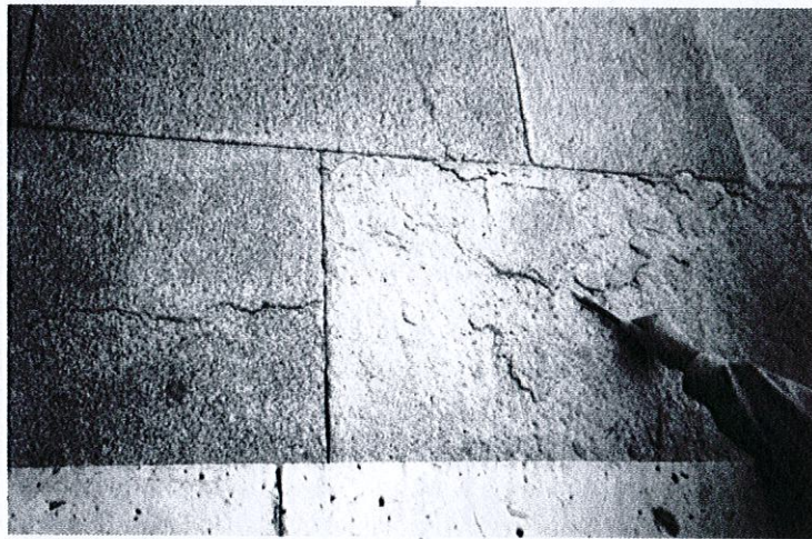
Fig. 3.- Desplacado en la superficie de un granito muy arenitizado. Separation in the surface of a sanded granite. Royal Palace, Madrid / Palacio Real, Madrid (Foto E. Pérez Monserrat)
