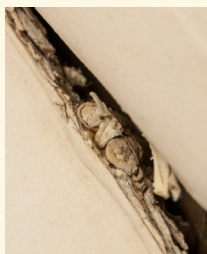
Fig. 70. Nervios seccionados, BH INC FL-1. ©J. Marquerie 2015
