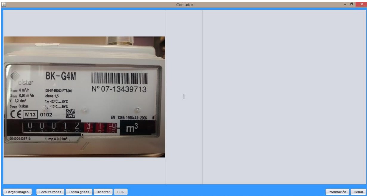
Figura A.3. Imagen cargada del contador de gas.
