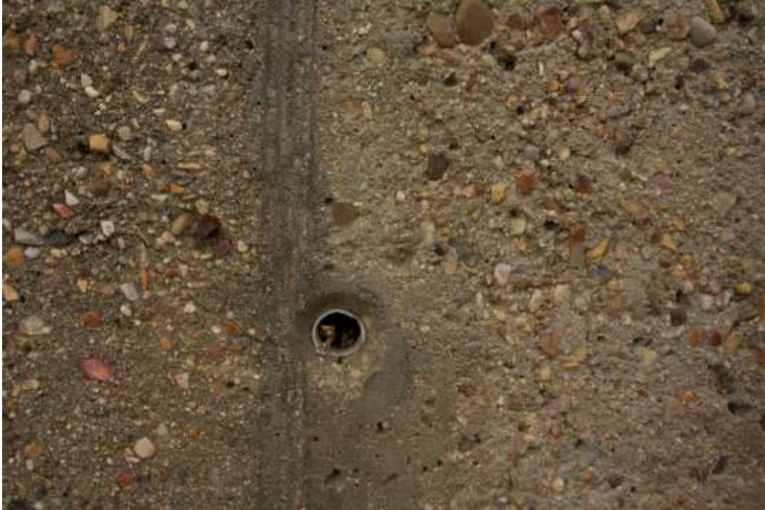
Ilustración 17. Detalle canal obstruido del hormigón.
