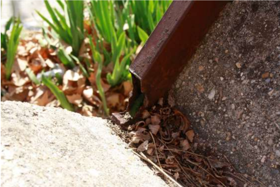
Ilustración 15. Detalle fractura en la barra de acero Cor-ten.
