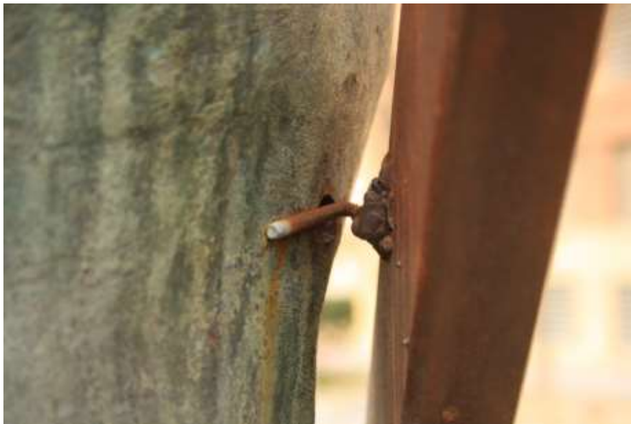
Ilustración 13. Detalle anclaje de la barra de acero Cor-ten a la figura de Diana.
