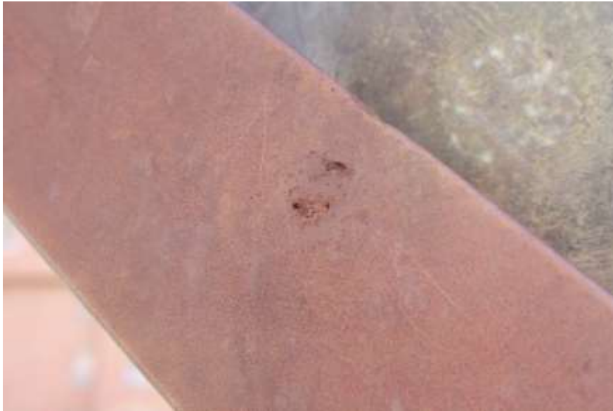
Ilustración 16. Detalle de oquedades en las barras de acero Cor-ten.
