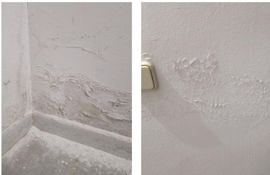
Figuras 39 y 40. Marcas producidas en las paredes del almacén a raíz de la inundación ocurrida en 2014. Fotografías realizadas por la autora.
