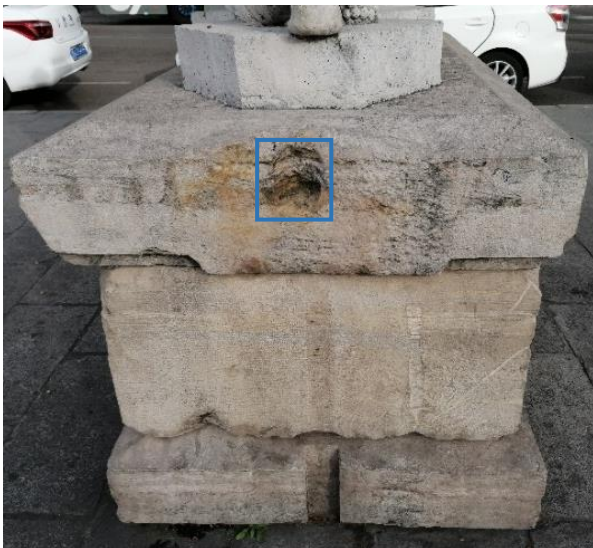
Fig. 18: Estallido en el lateral derecho del pedestal.
