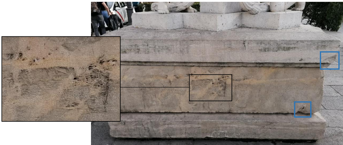
Fig. 22: Los recuadros azules muestran las desconchaduras en los bordes de los bloques superior y central del pedestal. El recuadro negro muestra en detalle el área que ha sufrido una pérdida de matriz.
