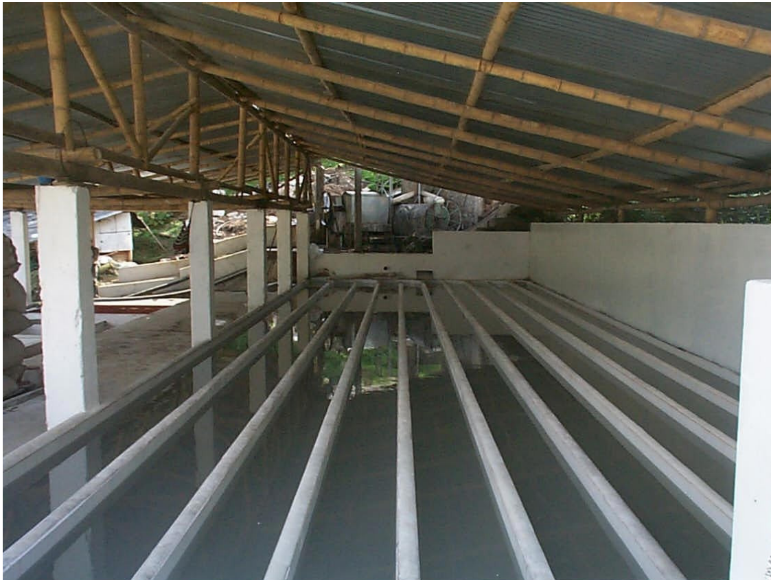
Figura 12. Fotografía de la rallandería 3 donde podemos ver los canales de sedimentación y al fondo la máquina coladora.
