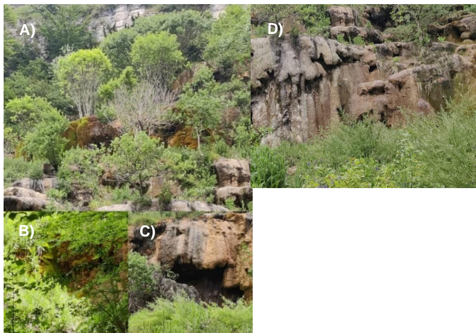
Figura 15. Imágenes de detalle. A) Presencia de musgo en las tobas calcáreas. B) y C) goteo en las paredes. D) pared seca. Fuente: Elaboración propia.
