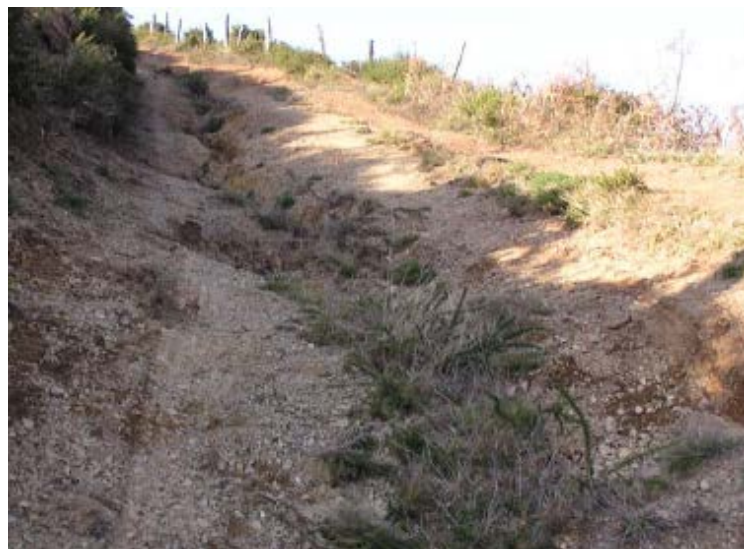
Vial con firme MALO, presencia constante de cárcavas
