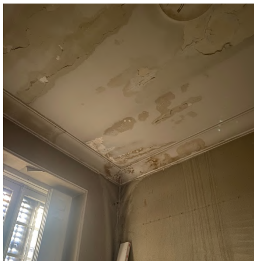
Figura 13: Humedades y filtraciones de agua
