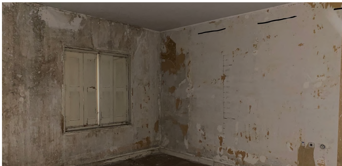
Figura 12: Habitación amplia con humedades y sin luz
