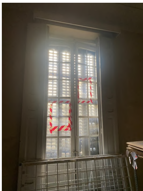
Figura 11: Ventanas rotas y cubiertas con lonas
