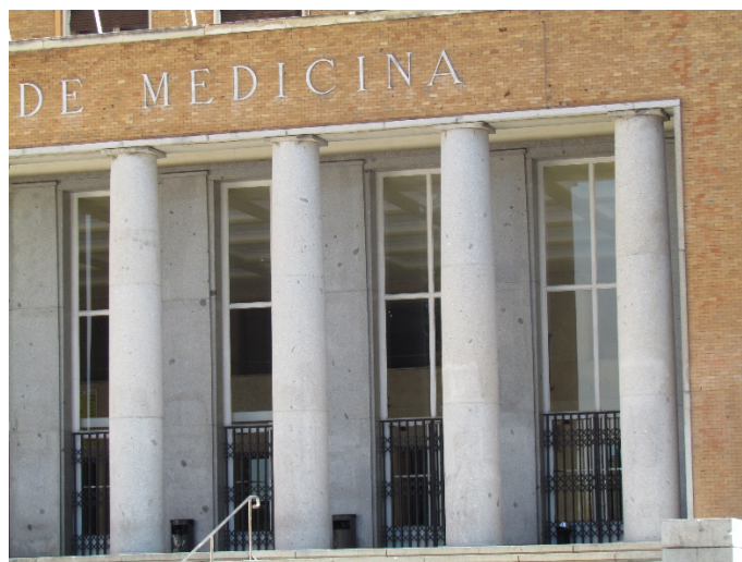
Restos de balazos en la fachada de la Facultad de Medicina. Fuente: A. Castillo. 2015
