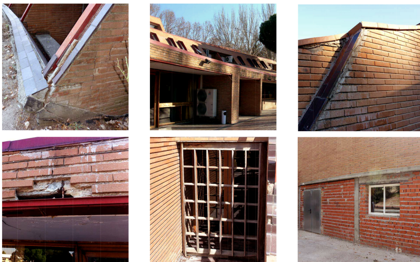
Figura 2. Ejemplos de patologías constructivas. Fuente: elaboración propia.
