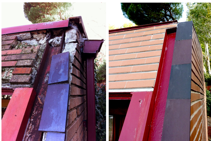
Figura 3. CMANSL. Patología detectada (izda.) y resuelta (dcha.). Fuente: elaboración propia.
