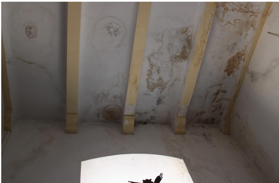
Fig. 11. Efecto de las humedades sobre los muros y techo de la iglesia. Se aprecia la marca de la gotera existente sobre el retablo. Fuente propia.
