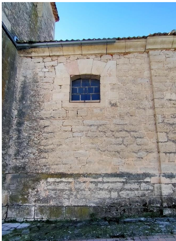
Fig.10. Exterior de la pared noroeste de la iglesia. Se aprecian los deterioros y colonización biológica por humedad en los pilares. Fuente propia.
