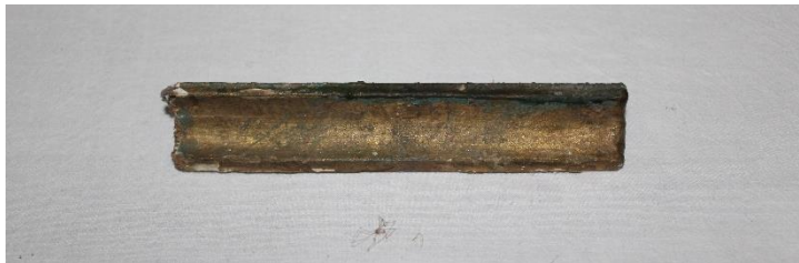
Fig. 15. Detalle de elemento desprendido de una de las cornisas. Fuente propia.
