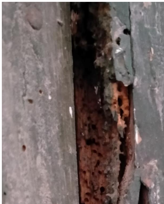
Fig. 14. Detalle del soporte atacado por xilófagos. Fuente propia.
