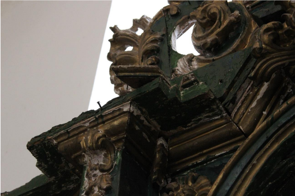
Fig. 42. Detalle de los deterioros de la cornisa izquierda. Elementos con riesgo de desprendimiento.
