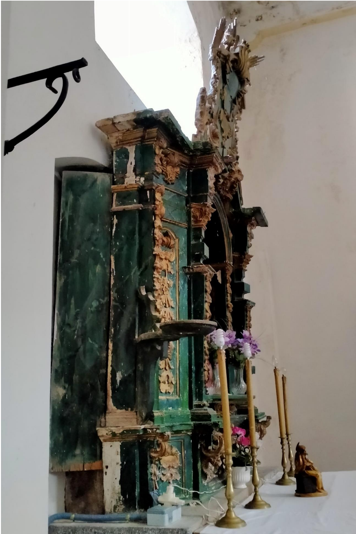
Fig. 44. Lateral del retablo del Perpetuo Socorro. Se aprecian los numerosos daños y la mala colocación de la instalación eléctrica. Fuente propia.
