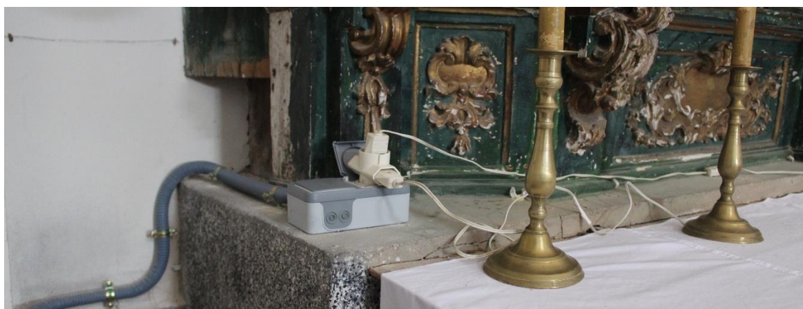
Fig. 41. Mala ubicación de la instalación eléctrica. Fuente propia.
