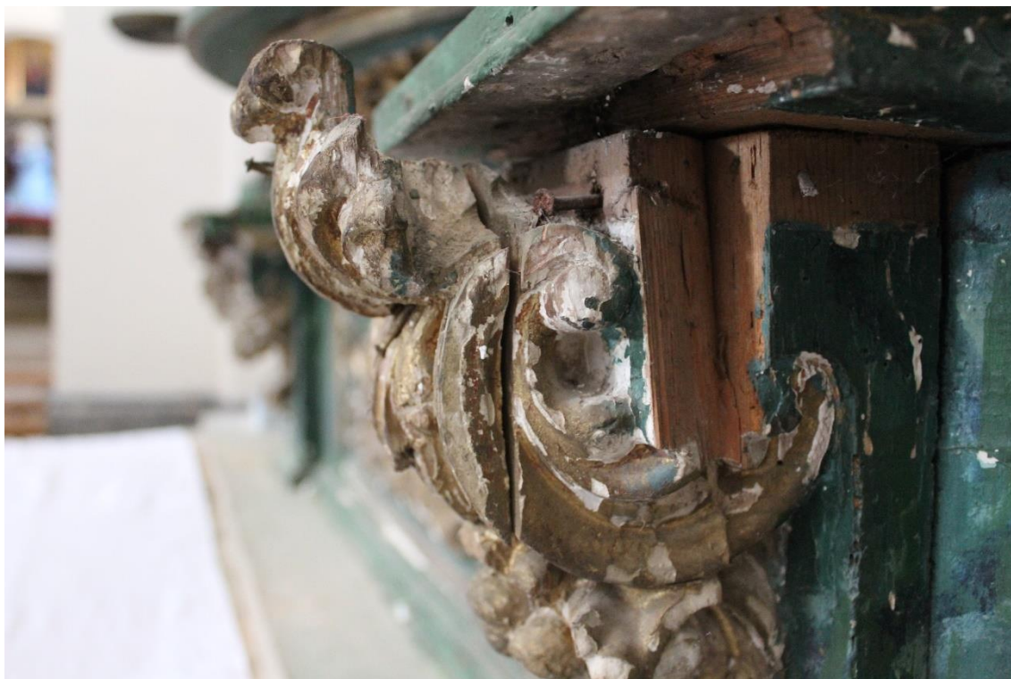
Fig. 19. Detalle de motivo ornamental con peligro de desprendimiento por la pérdida de funcionalidad de los clavos. Fuente propia.
