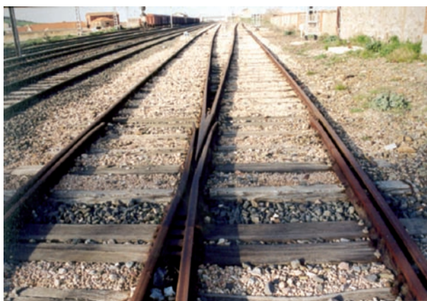
Vías de servicio y maniobras de la Estación ferroviaria de Santa Cruz de Mudela.
