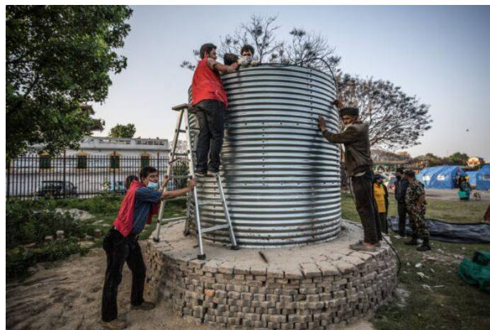
Ilustración 24. Tanque Oxfam 11 metros cúbicos. (Oxfam Supply Center, 2024)
