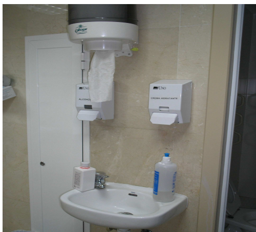
Figura 10. Punto de Higiene de Manos de una unidad de Alto Riesgo
