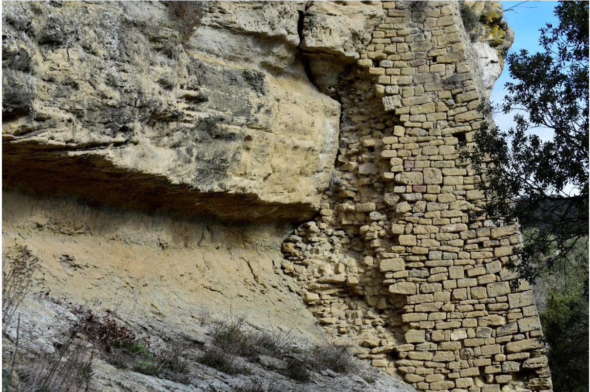
Figura 38. Contrafuerte disgregado en el lado sur del conjunto (2023). Fuente: propia.
