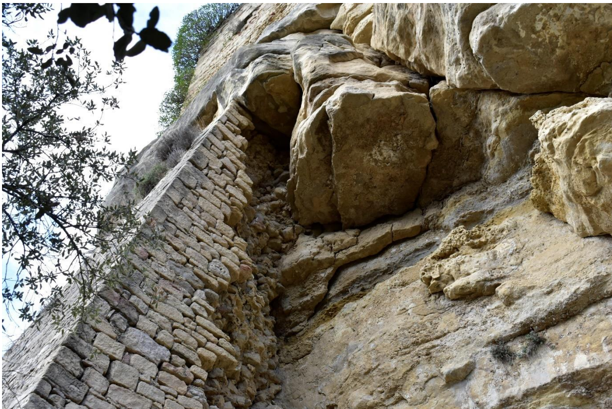
Figura 37. Contrafuerte disgregado en el lado sur del conjunto (2023). Fuente: propia.
