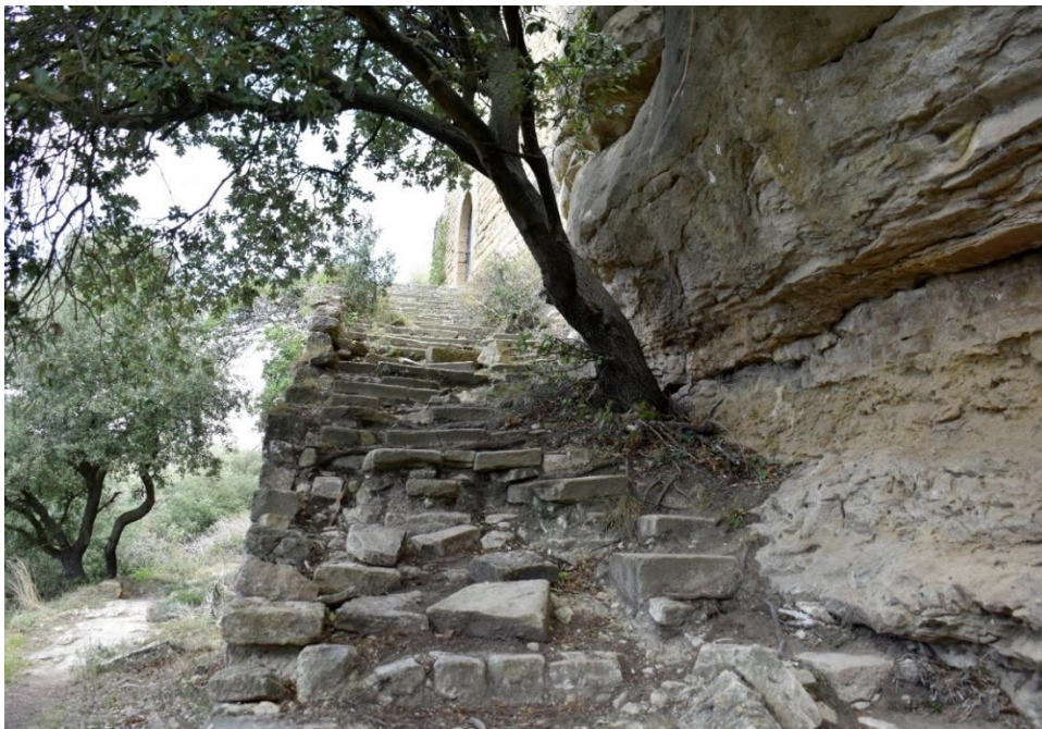
Figura 7. Escalera de la entrada con la barandilla en mal estado de conservación (11 de noviembre de 2023). Fuente: propia.
