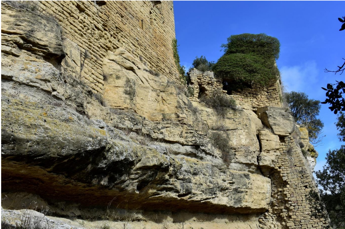
Figura 36. Estado de la roca en el lado sur del conjunto (2023). Fuente: propia.
