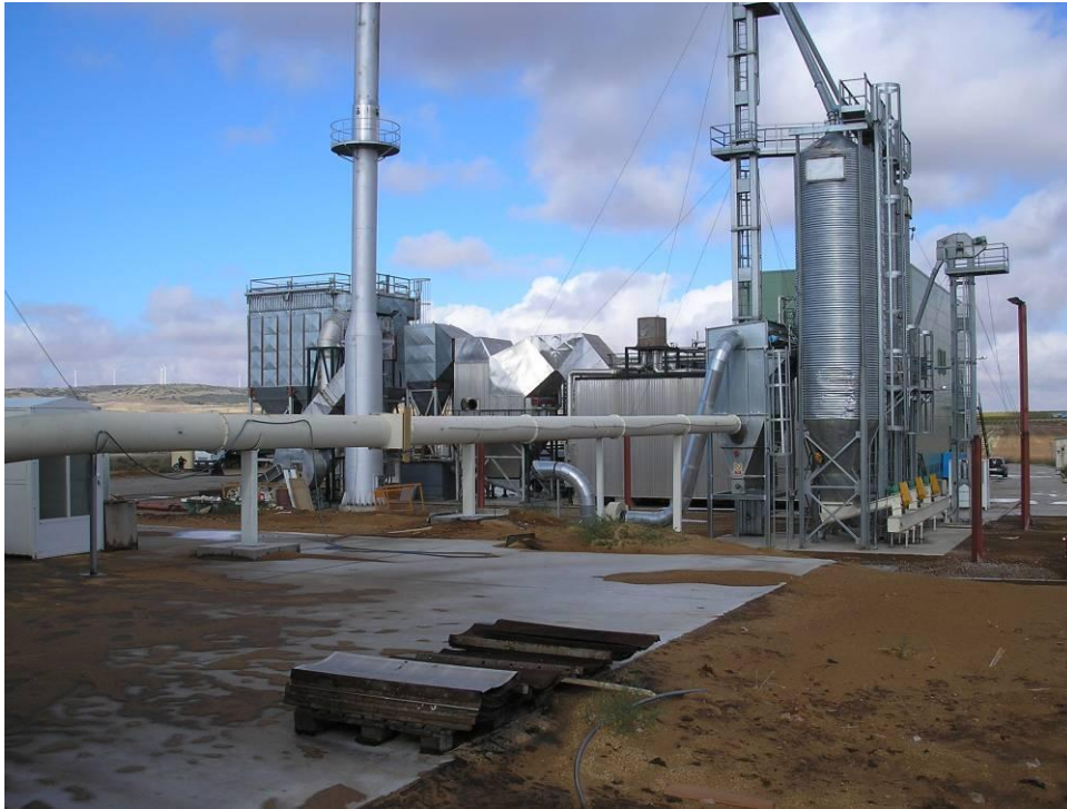
Foto 22 vista de la caldera actual y los silos de alimentación
