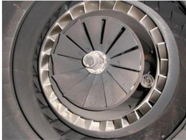
Foto 13 Frente del quemador de doble zona de aire: Coen DAZ
