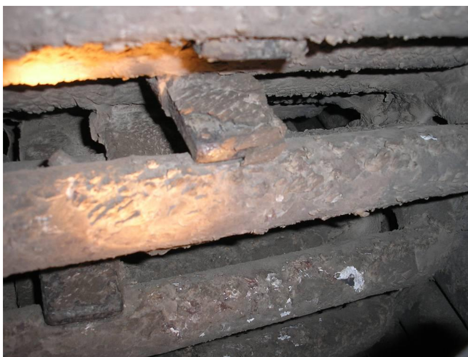
Foto 21 Estado de ensuciamiento del Sobrecalentador
