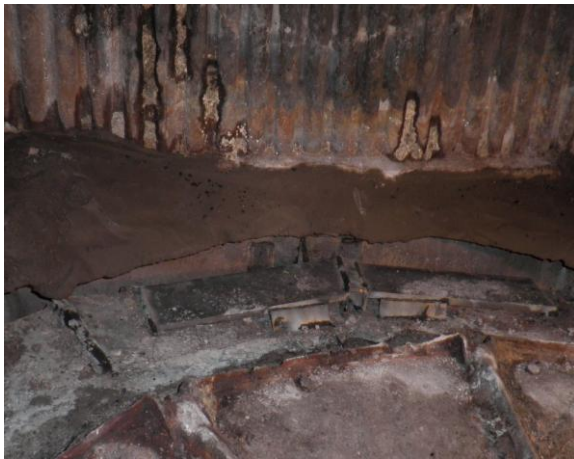
Foto 44 Platos de la parrilla de un gasógeno antes y después de la abrasión por escorias
