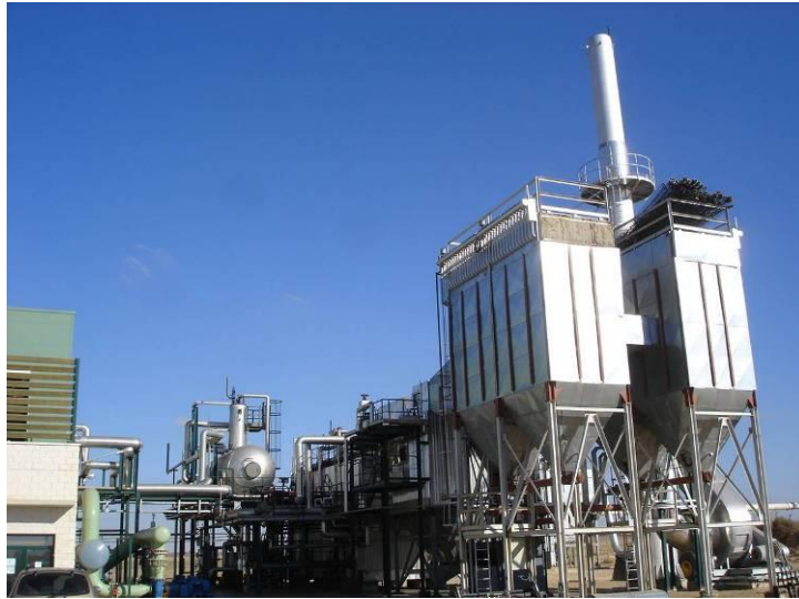
Foto 10 Vista general de caldera y sistema de depuración
