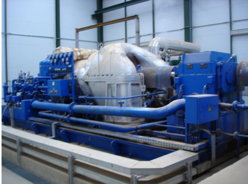
Foto 14 Vista de la Turbina
