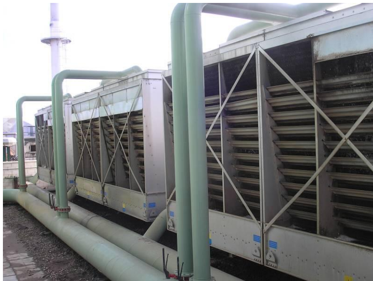
Foto 17 Torres de refrigeración
