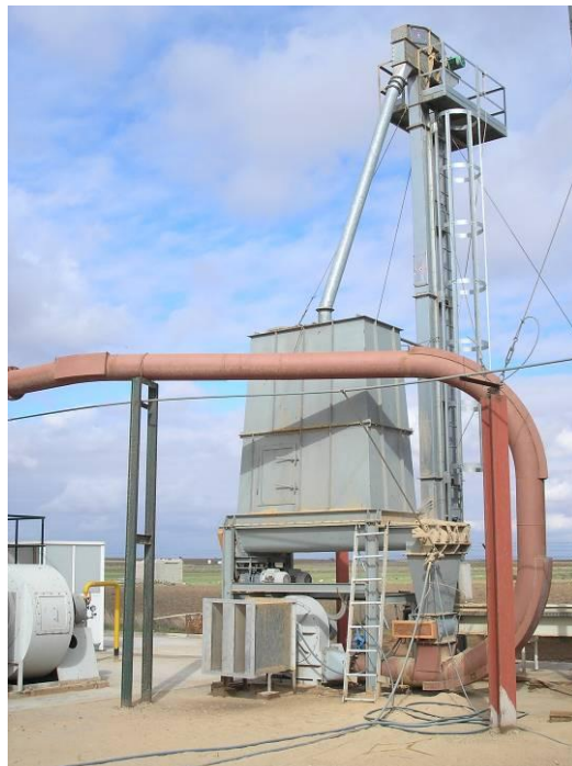
Foto 9 Alimentador serrín a caldera
