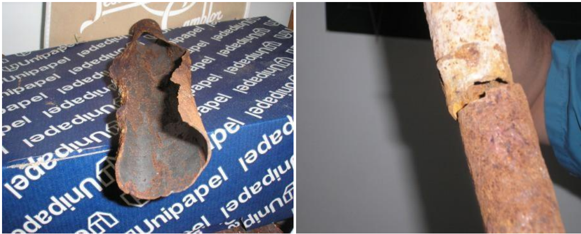
Foto 47 Detalle de roturas de los tubos de sobrecalentador
