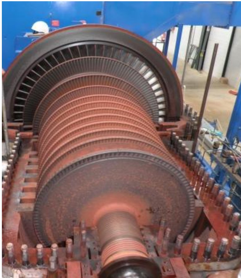
Foto 15 Turbina abierta en revisión
