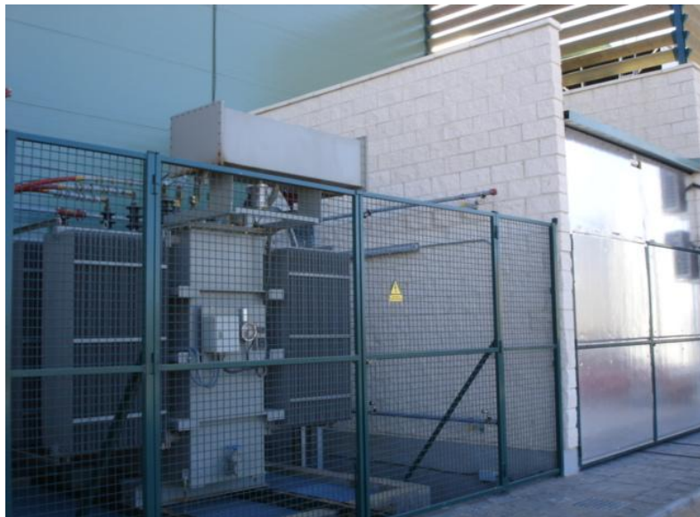
Foto 18 Transformador de salida
