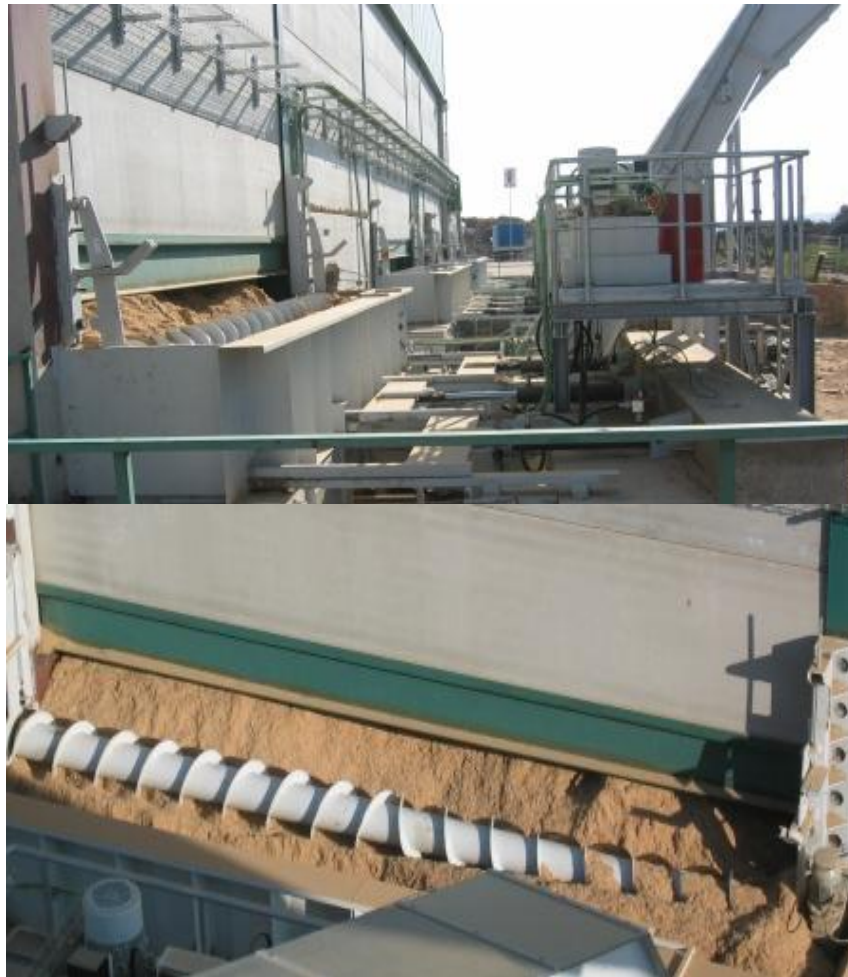
Foto 41 vistas de las salidas de material hacia los transportadores
