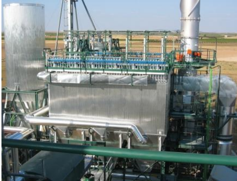
Foto 42 sistema de tratamiento de gases
