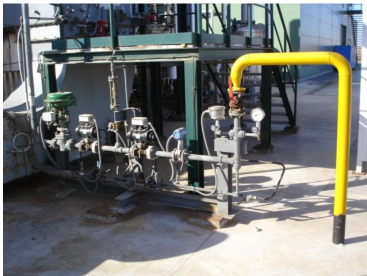
Foto 19 Acometida de gas a Caldera
