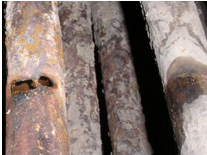
Foto 27 rotura de tubo por desprendimiento en capas
