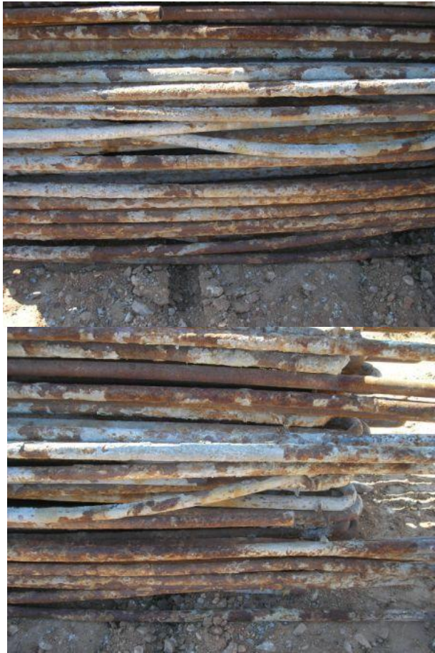
Foto 46 Detalles del sobrecalentador dañado
