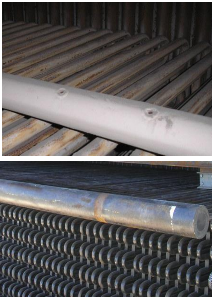
Foto 29 Nuevo sobrecalentador vista superior y frontal
