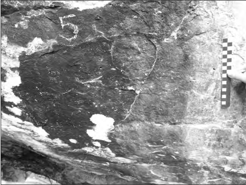
FIGURA 12. Lesiones mecánicas área 3, exfoliación y pérdidas de la roca.
