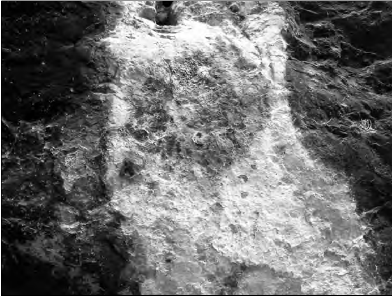
FIGURA 9. Detalle del área 2, depósitos de elementos contaminantes de combustión y carbonataciones de la superficie.
