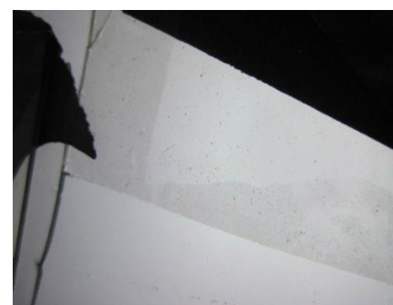
Fig. 23. Suciedad y polvo acumulado.
