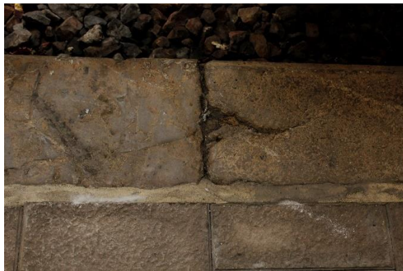
Fig.71: Presencia de sales en el andén del Museo del Ferrocarril de Asturias, 2020.
