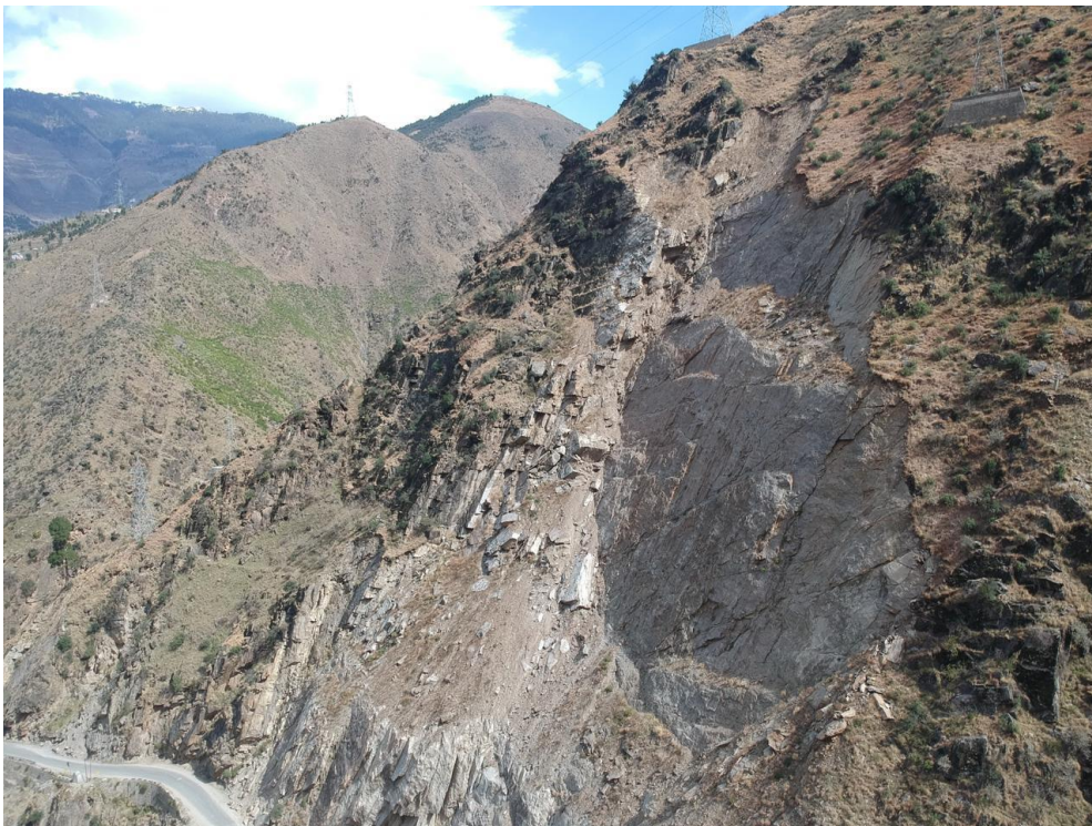
Foto 3.2 Vista cicatriz deslizamientos anteriores (Space & EPSA, 2020)
