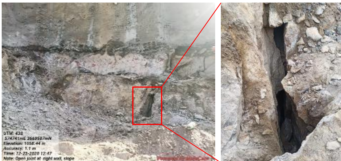
Foto 3.4 Grietas abiertas en el macizo de la margen izquierda del río (Space & EPSA, 2020)
