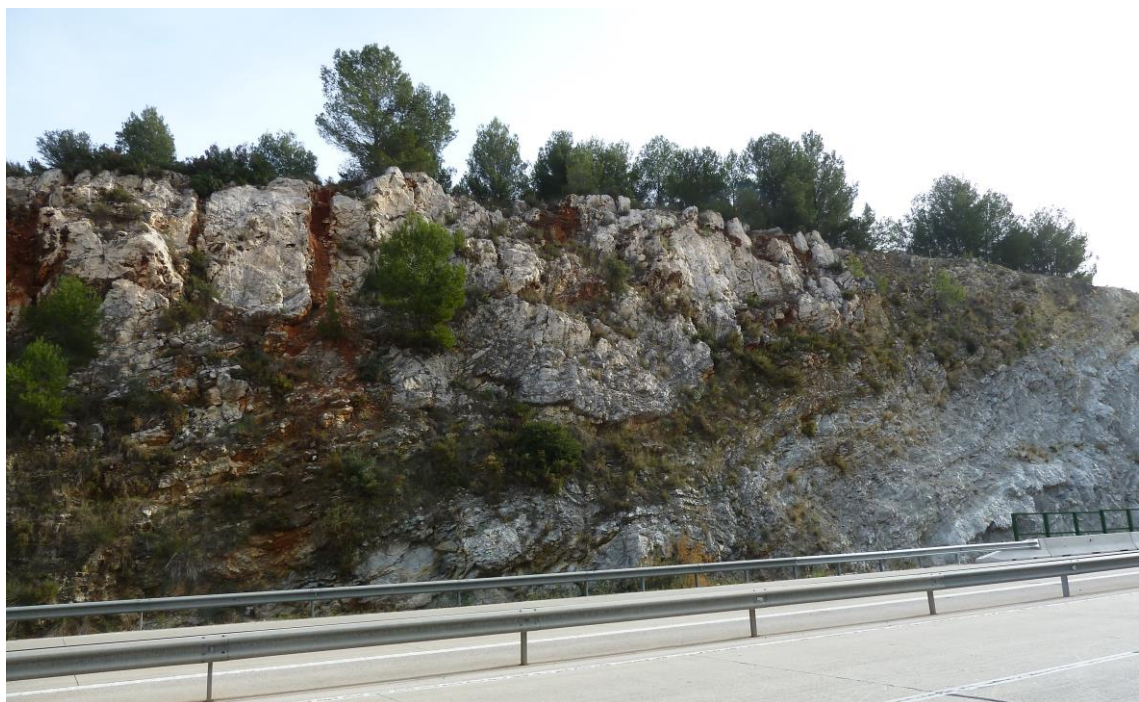
Foto 4.2 Ladera sobre el túnel con fracturas longitudinales abiertas (Castanedo, 2015)
