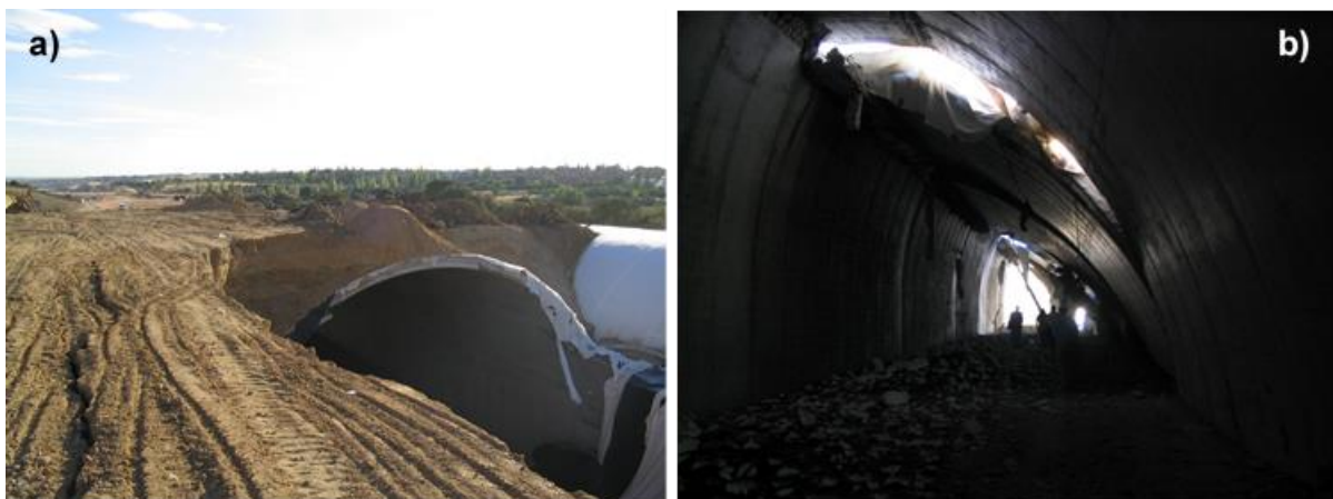
Foto 2.1 a) Relleno claramente asimétrico sobre túnel artificial. b) Túnel colapsado (Castanedo, 2015)
