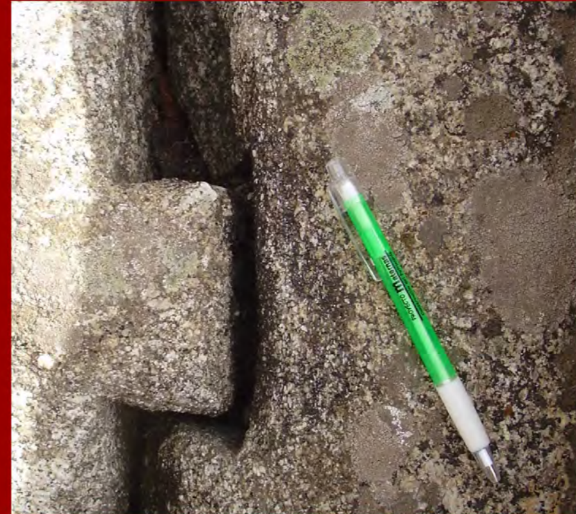
Pintadas y eflorescencias
