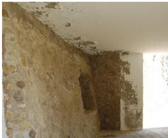
Detalle de las humedades en el interior del muro de cierre del espacio del almacén y vista del exterior en el nivel superior de este ámbito en el que se observan igualmente estas humedades.
