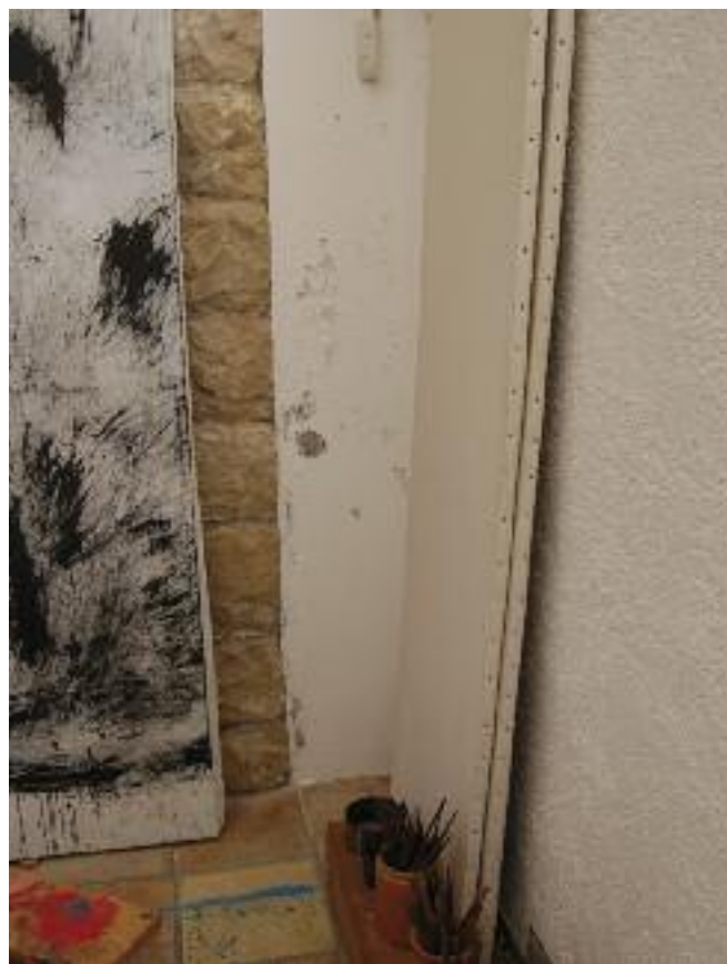
Efectos de las filtraciones de humedad en un extremo del interior del muro oeste del taller, ocultas por las obras. Podía haber más focos de humedad originadas por la evacuación de agua de la cubierta a través de la gárgola existente el exterior de este muro.
