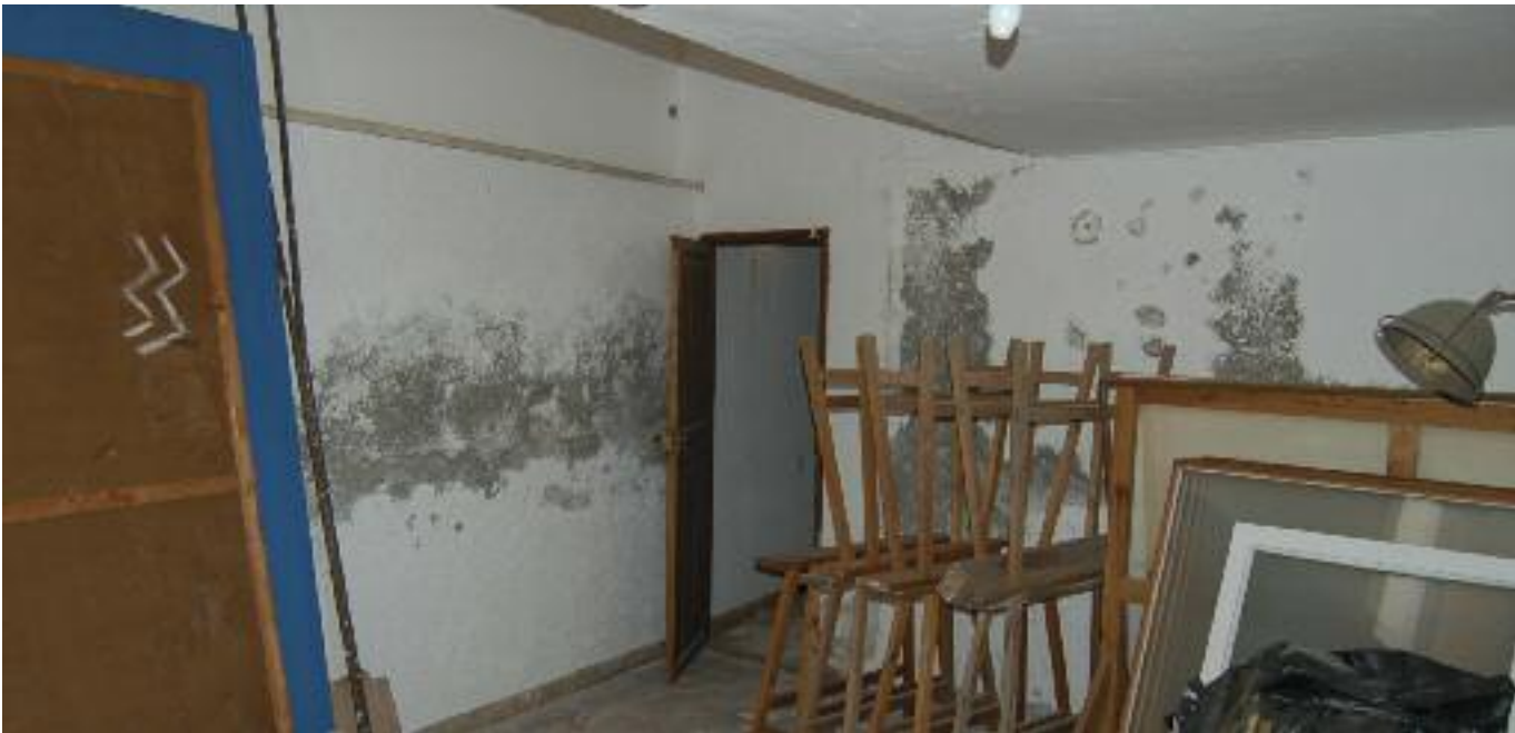
Vista general del almacén en la que se pueden ver claramente las zonas afectadas por humedades.
