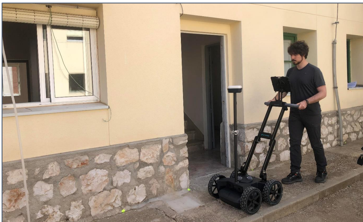
Figura 9: Toma de medidas del perfil de georádar PG 3-B antes de la actuación. En la base del muro, se puede apreciar un marcado amarillo fosforito, que indica los puntos a perforar para inyectar la resina.
