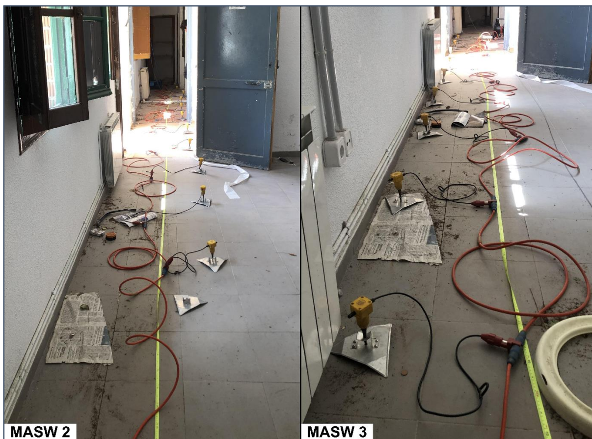
Figura 10: Ubicación de los perfiles de sísmica MASW 2 y MASW 3 previos a la inyección. Se puede apreciar que los geófonos del MASW 2 están separados unos 50 cm del muro en el que se van a realizar las inyecciones.
