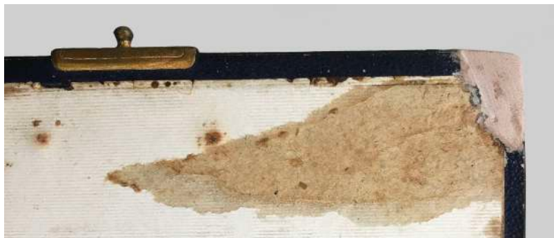
Fig. 35. Pérdida de la capa superficial de la guarda. Se observa que la alteración comienza justo en la zona donde se ha perdido el soporte de la cubierta
