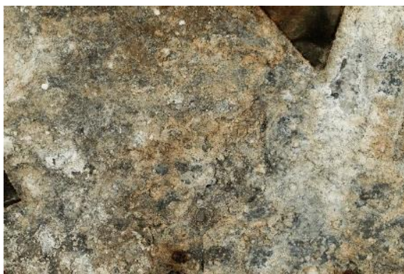
Fig. 52. Corrosión generalizada en presencia de ataque de hongos.
