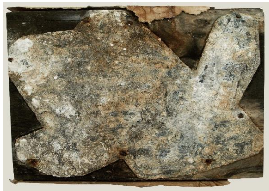
Fig. 49. Pérdida parcial de la camisa en la plancha S.02.
