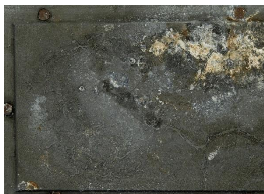
Fig. 53. Corrosión puntual junto con el ataque de hongos.
