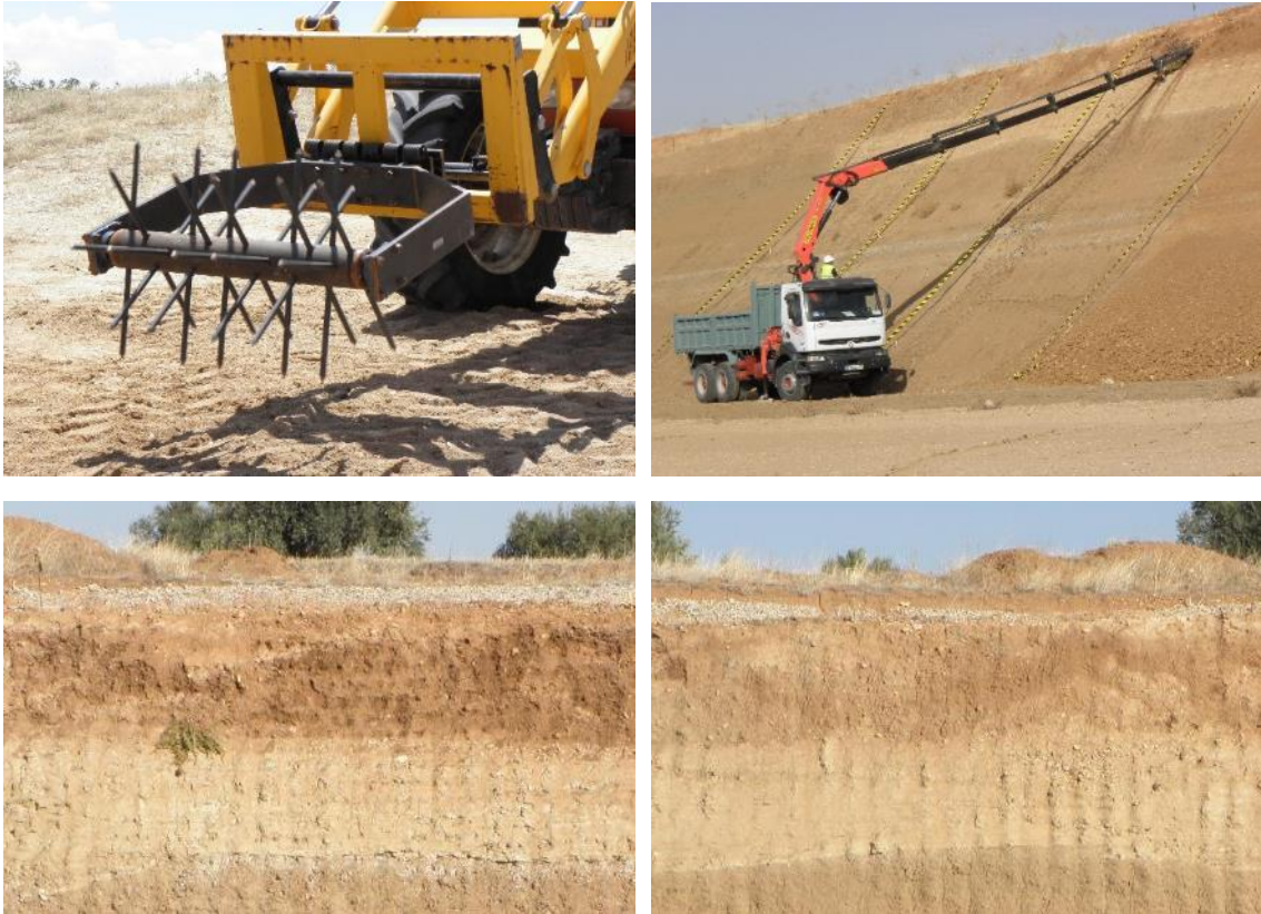
Figura 6.5. En la parte superior derecha, detalle del apero construido para desarrollar el procedimiento patentado montado sobre un tractor. Arriba a la derecha trabajando sobre un desmonte, montado en esta ocasión sobre una grúa hidráulica articulada. Abajo a la izquierda, efecto del apero sobre el desmonte a la izquierda y sin tratamiento a la derecha. Se parecía claramente la irregularidad que aporta el tratamiento en forma de numerosas pequeñas escarificaciones en la superficie del desmonte. Desmonte construido sobre lutitas (M-224, Torres de la Alameda, Madrid).
