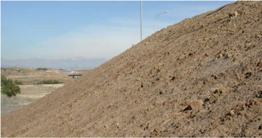
Figura 5.7b. Evolución de un terraplén T-1 desde 2004, cuando se realizaron los extendidos de tierra vegetal antes de la hidrosiembra, hasta 2008 (falta la foto de 2007)
