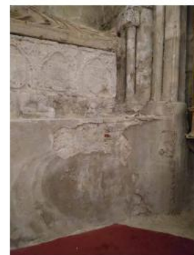
Fig. 3 Capilla de San Isidro, lesiones en el revestimiento y arcosolio.
