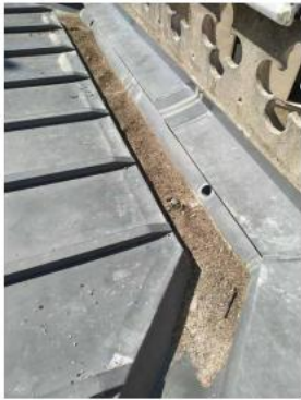
Fig. 4 Capilla de La Virgen Blanca, cubierta con sumideros obstruidos.
