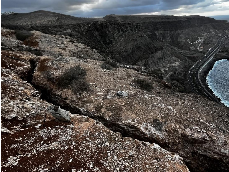
Figuras 06: Vista actual de parte de la grieta principal. La grieta sigue paralela al hombro del talud del acantilado. Nótese la amplitud de la abertura de la grieta principal.
