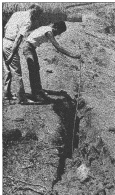
Figura 02: Muestra el detalle de uno de los tantos surcos (surco 18), fotografiado en 1985, durante las labores de inspección posteriores a la aparición de grietas en la coronación del talud. Esta imagen permite ilustrar visualmente las evidencias de deformación superficial observadas en aquel periodo.
