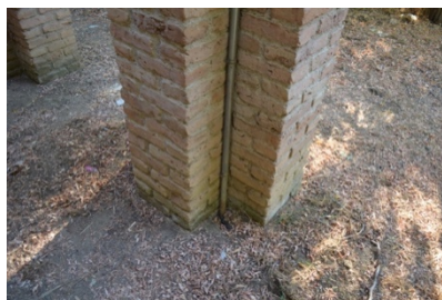
Figura 68 a 73.- Estado de conservación actual de la escultura: la arboleda oculta parte de la obra; grafitis y líquenes en las paredes exteriores e interiores, y residuos en el terreno. Fotos: Lara Rodríguez-Seara
