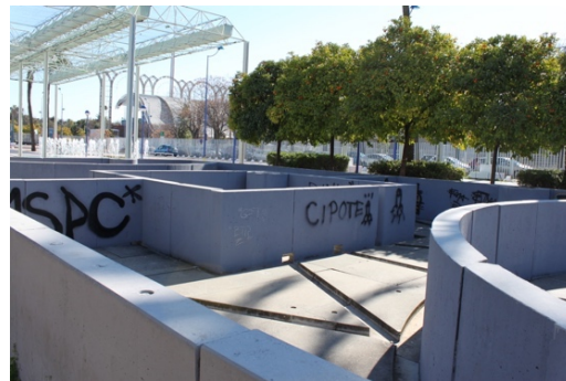
Figura 14.- Estado actual de la obra Sin título , con el paso de los años la obra de ha utilizado como fondo para los grafitis. Lara Rodríguez-Seara
