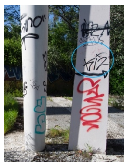
Figura 29.- Estado de la obra en el año 2018. Restos de pintura roja de grafiti y columna repintada de blanco. Foto: Lara Rodríguez-Seara
