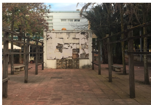
Figura 10.- Estado actual de la obra de Kavakov, totalmente irrecuperable. Los dibujos ya no se encuentran en los paneles y el mural está completamente deteriorado. Foto: Lara Rodríguez-Seara
