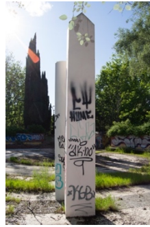
Figura 30.- Estado de conservación actual de la obra y su entorno, completamente abandonados. Figura 31.- Grafitis por todas las caras de la obra. Fotos: Lara Rodríguez-Seara
