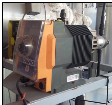
Figura C.6. Bomba de agua de alimentación BO-01.
