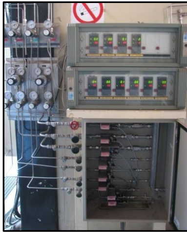
Figura C.5. Manorreductores y controladores de flujo másico, respectivamente.
