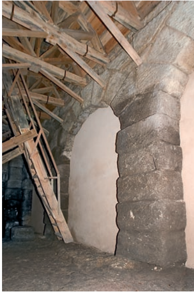
Cuevas de Hércules. Complejo hidráulico de época romana. Fase I realizada en el 2004. Propiedad del Consorcio.
