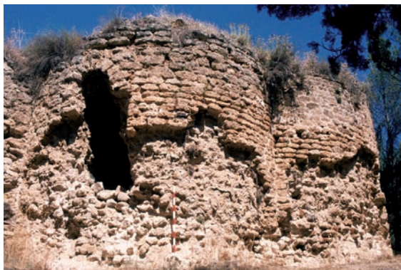
Estado de deterioro de los ábsides Sur y Este del Mausoleo. En su mitad inferior, incluso alcanzado los 2 - 3 metros de alzado, faltan las hiladas de opus vittatum del paramento, dejando al descubierto el opus caementicium que forma su interior, y que a la vez está sufriendo un proceso de degradación y disgregación de los materiales que lo componen. La pérdida de material constructivo exterior puede provocar una caída de la estructura del ábside, poniendo en peligro la estabilidad del edificio.
