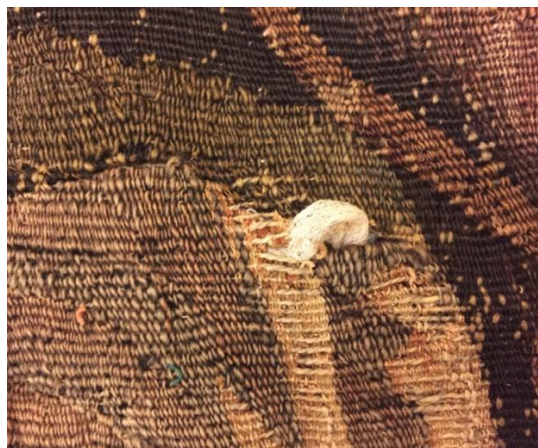
FOTOGRAFÍA 21. DETALLE DE LA GASA QUE POSEE EL TAPIZ POR EL REVERSO EN ALGUNAS ZONAS.
