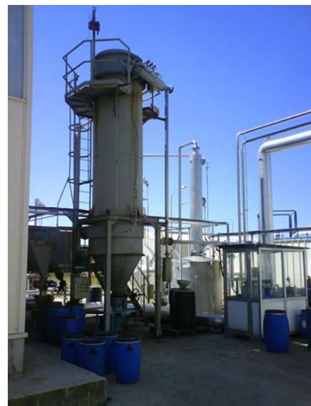
Figura 10. Sistema de limpieza de gases.
