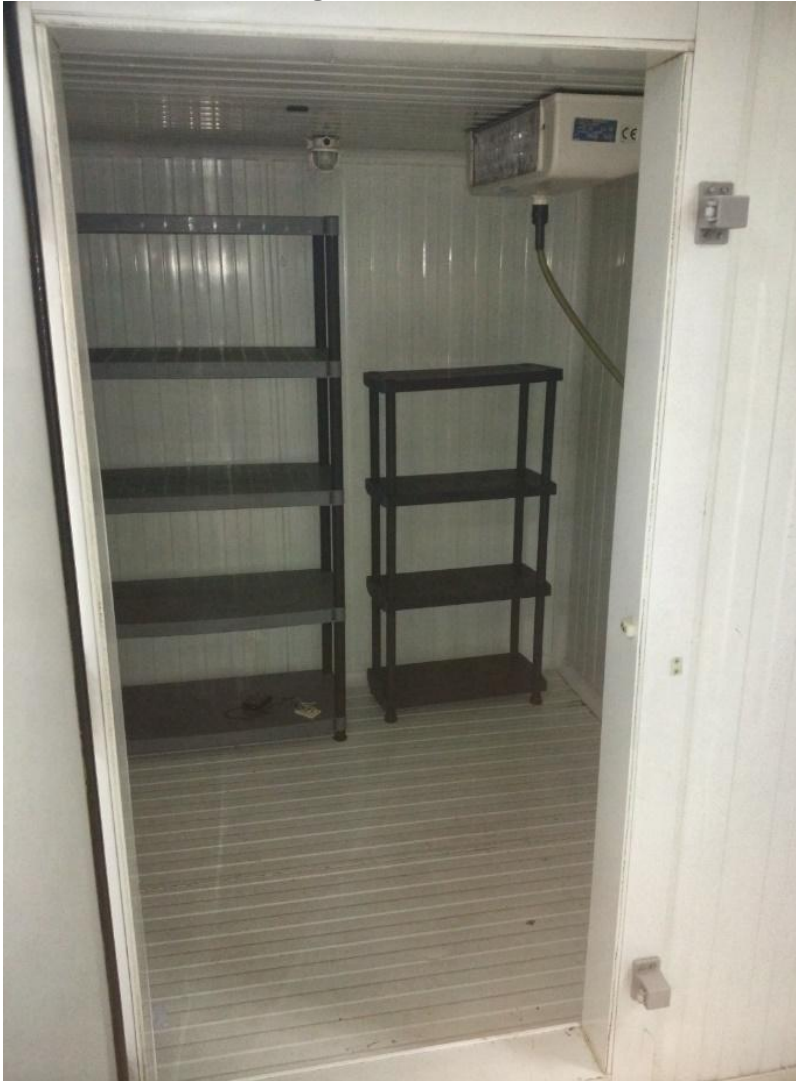
Figura 4.1.7 Interior cámara frigorífica
