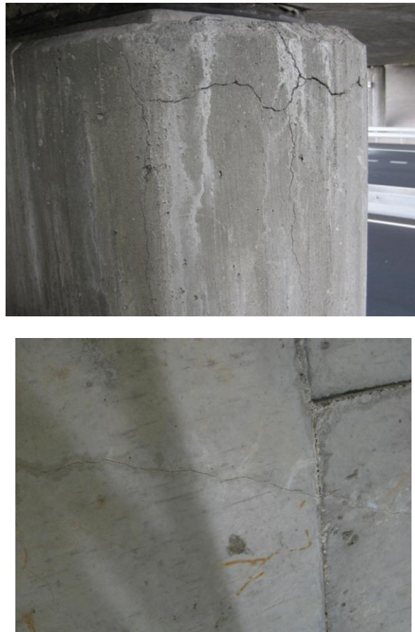
Figura 8 Estructuras de hormigón con fisuras (CEDEX,2023)
