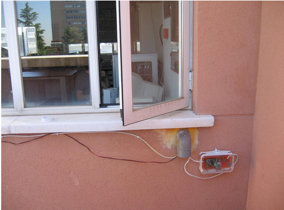
Figura 19: Sistema de encendido automático en la terraza sur.
