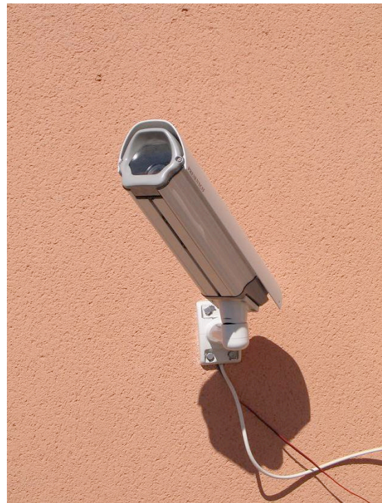
Figura 14: Primer plano de la cámara de bólidos.
