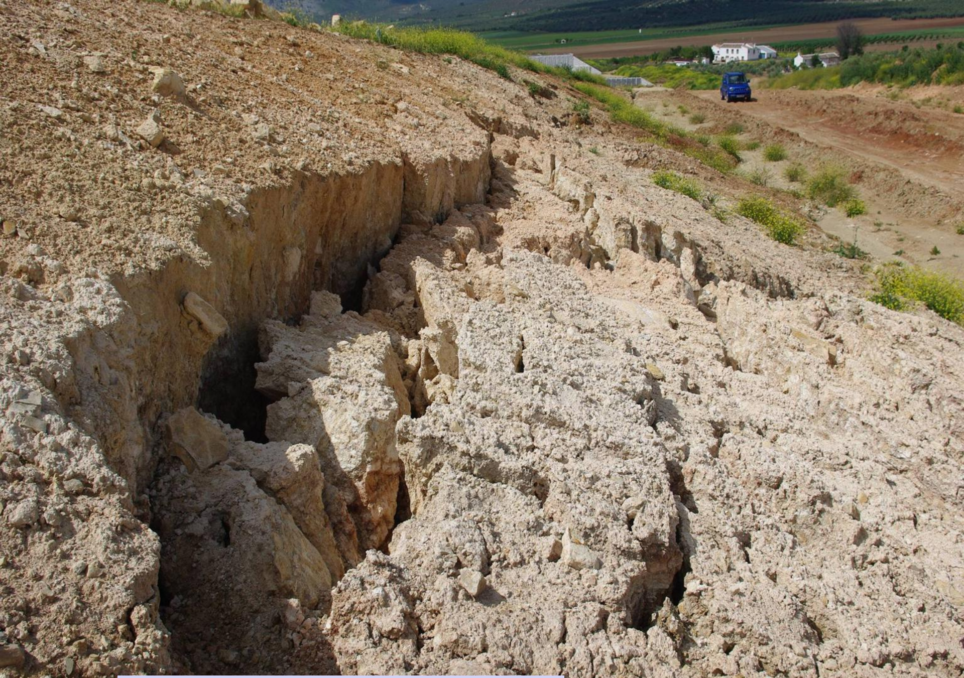
Grietas en arcillas expansivas, Antequera
