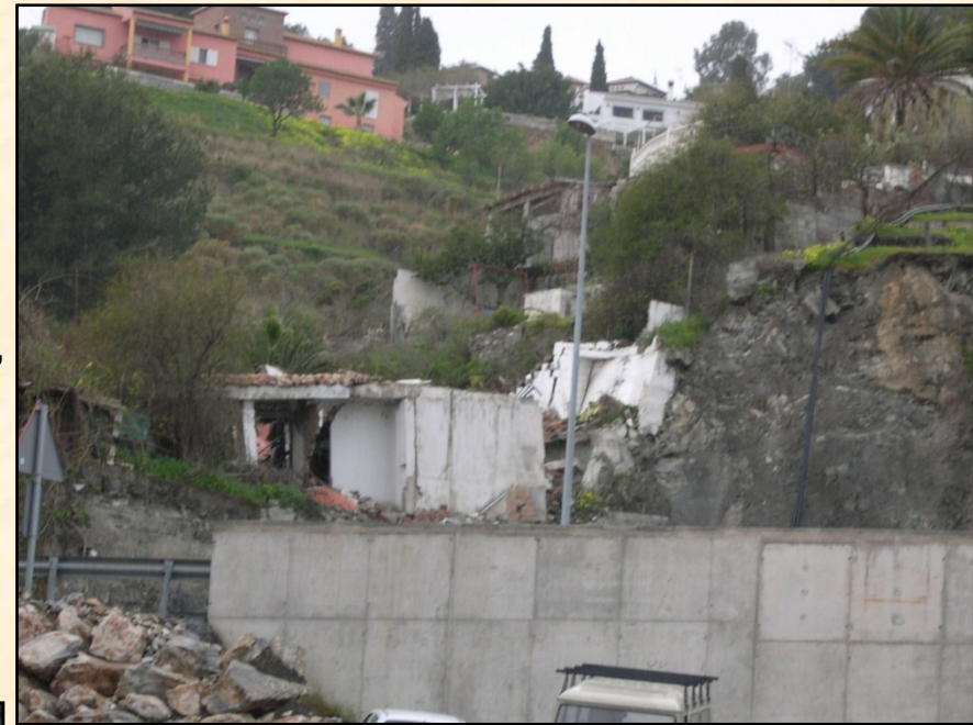
Deslizamiento rotacional en la zona de Granada
