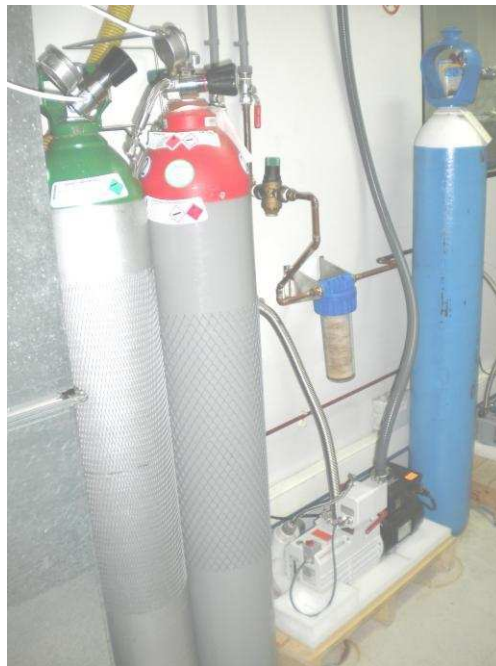
Figura 11. Botellas de gases en el pasillo de servicio. En la parte inferior derecha de la fotografía se puede observar la bomba rotatoria.
